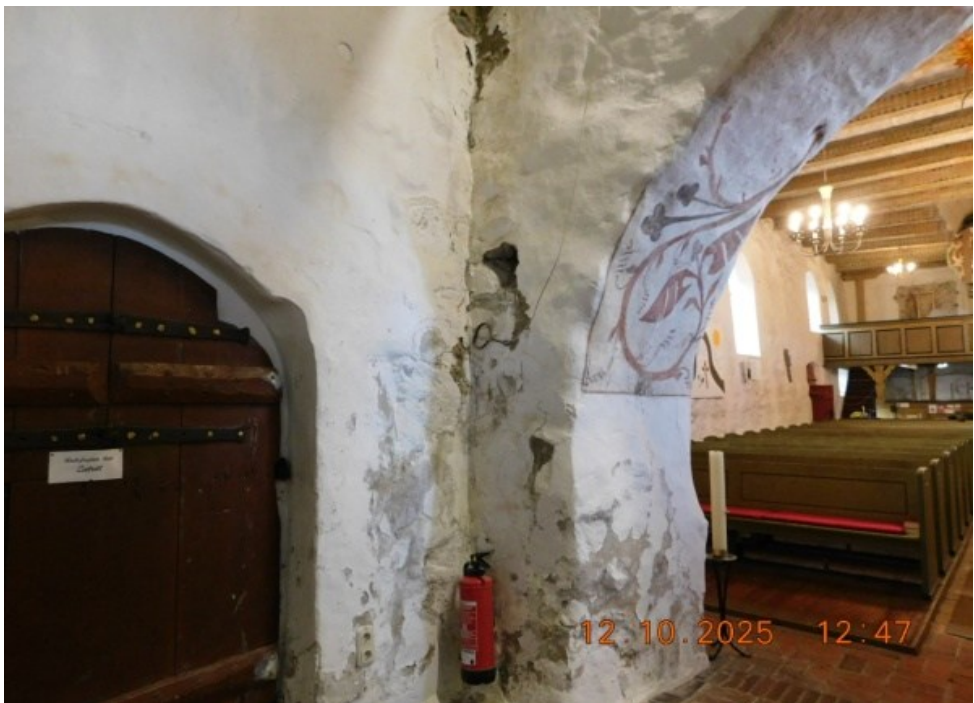
Abplatzungen und Risse im Chor
